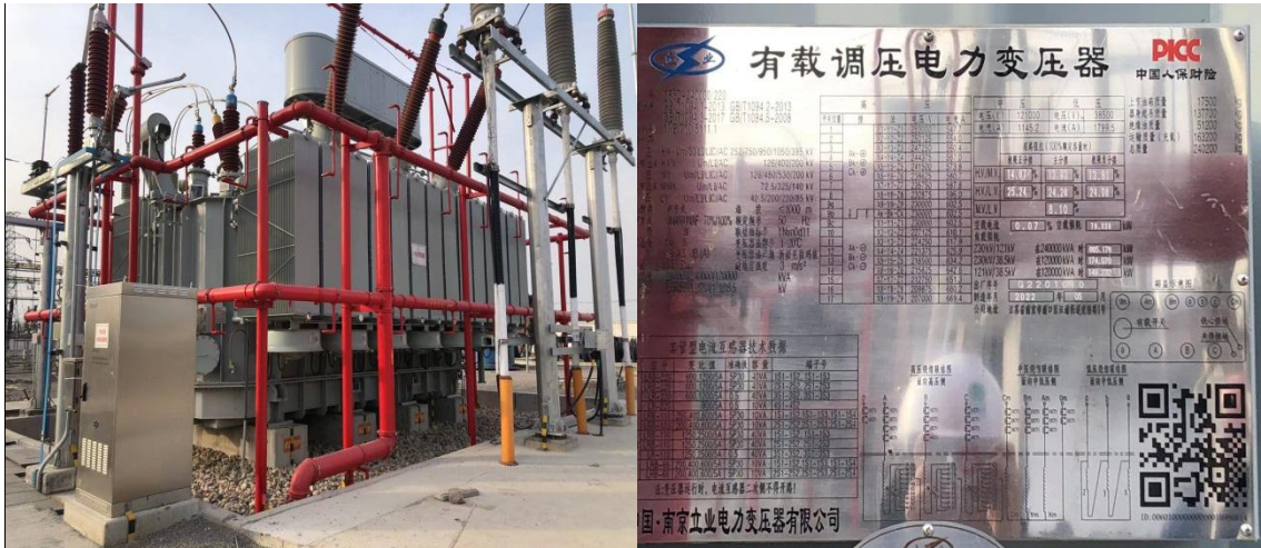
(2) 2号主变及铭牌
