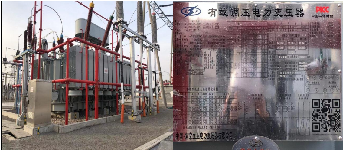
(1) 1号主变及铭牌
